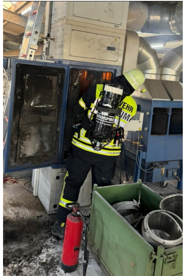
Brand von Filtermatten in einer Absauganlage.
