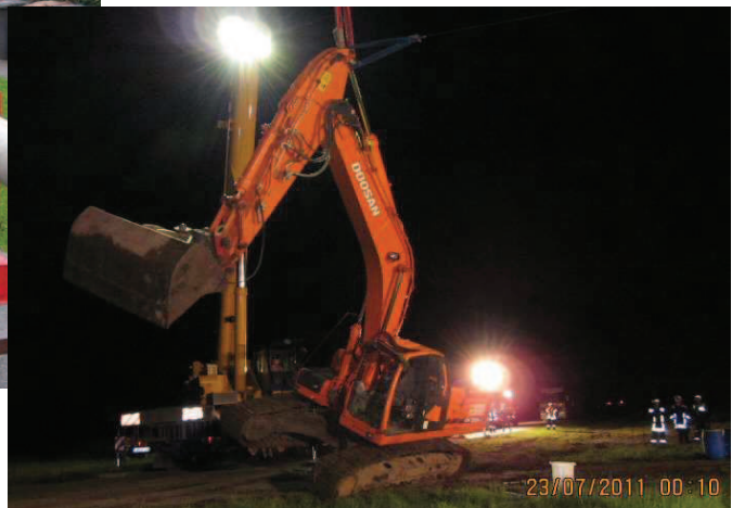
22.07. Umgestürzter Bagger WM 9 Pähl
